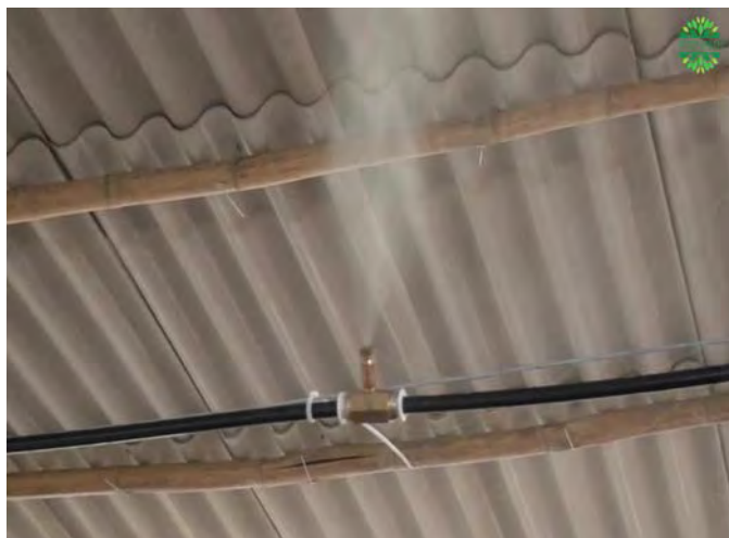
Hình 4.3.2. Hệ thống phun sương
