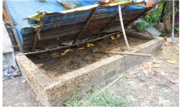
Hình 1.4.37. Bể xử lý bằng xi măng
