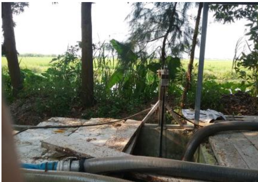
Bể lắng máy tách phân hộ nhà ông Trần Quốc Toàn- Xã Hải Quang- Huyện Hải Hậu
